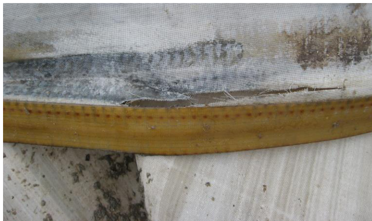
AFBEELDING 13 SCHADE AAN DE ZEEFBAND EN AANDRIJVING
